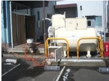
災害対応型LPガスタンクの活用例
