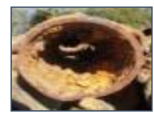
管路の老朽化が進行
