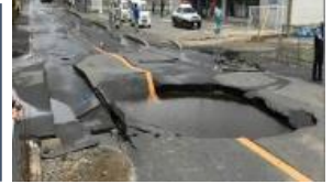
地震による管路の被災状況
