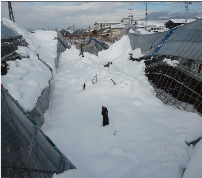
農業用ハウスの補強対策未実施
