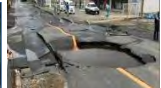
地震による管路の被災状況
