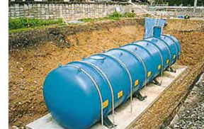
耐震性貯水槽
