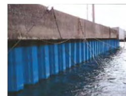
岸壁、鋼製矢板の腐食対策
