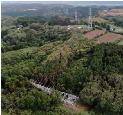
＜鉄塔の倒壊（君津市）＞
