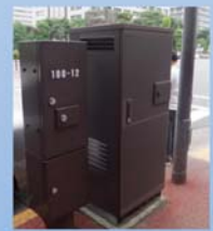
信号機電源付加装置
