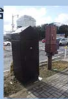
信号機電源付加装置
