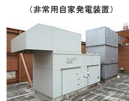
(非常用自家発電装置)
