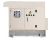
非常用発電設備
