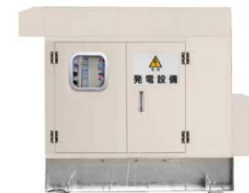
非常用発電設備
