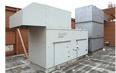
(非常用自家発電装置)
