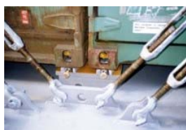
コンテナの流出防止対策 (固縛設備)
