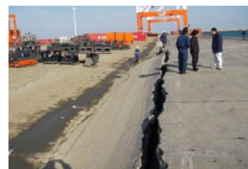
非耐震強化岸壁背後の陥没
