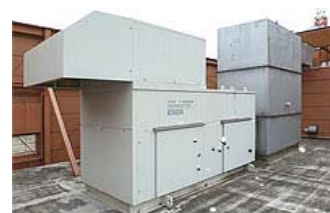
(非常用自家発電装置)
