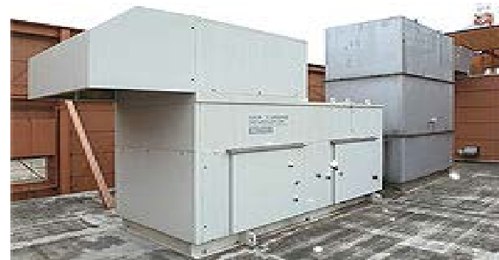
（非常用自家発電装置）
