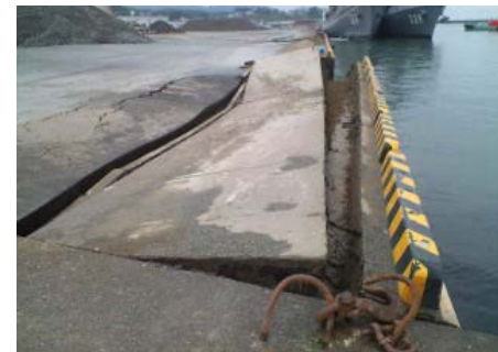
地震による岸壁の被災
