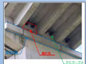
耐震対策の実施状況
