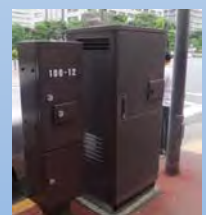
信号機電源付加装置
