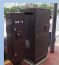
信号機電源付加装置
