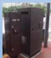
信号機電源付加装置
