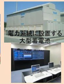
電力系統に設置する大型蓄電池 エネルギー需給制御システム
