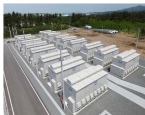
大型蓄電池 (レドックスフロー電池)
