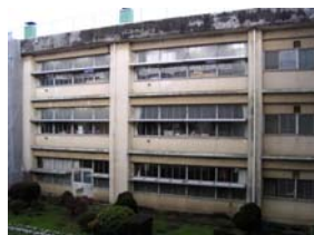
外装材の著しい劣化
