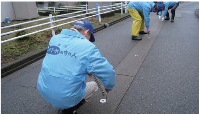
地下水を利用する消雪設備の点検
