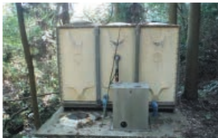
簡易給水施設(山間部)
