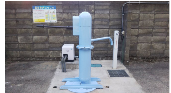
非常用防災井戸
