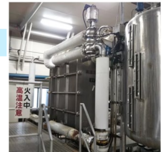
プレートヒーター（キッコーマン食品野田工場製造第2部）
