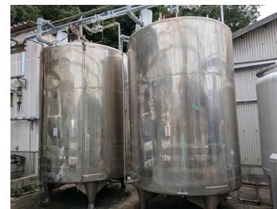
💧 冷却水回収タンク
