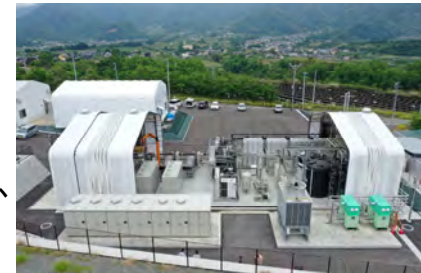
米倉山に設置されている P2Gシステム (山梨県)
