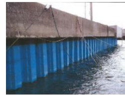
岸壁、鋼製矢板の腐食対策
