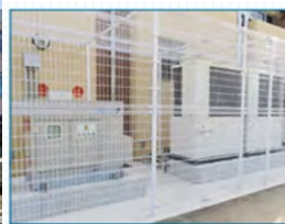
GHP及び非常用発電機
