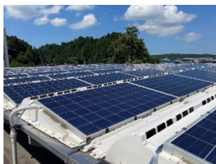
令和6年能登半島地震で 機能発揮した太陽光発電 設備(珠洲市役所)
