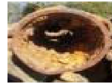
管路の老朽化が進行
