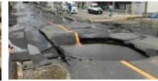
地震による管路の被災状況
