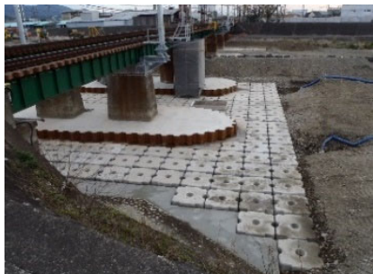
鉄道橋梁の流失・傾斜対策
