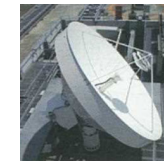
衛星通信システム
