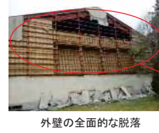
外壁の全面的な脱落
