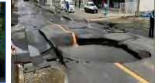
地震による管路の被災状況
