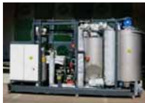
木質バイオマス利用熱電併給装置
