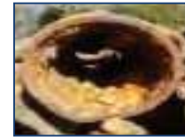
管路の老朽化が進行
