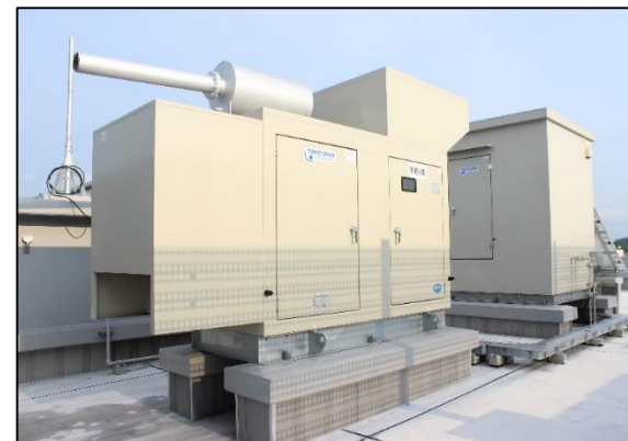
非常用電源の確保
