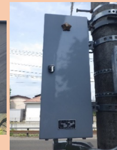
信号機電源付加装置
