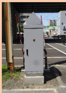
信号機電源付加装置
