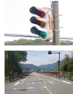
老朽化した交通安全施設
