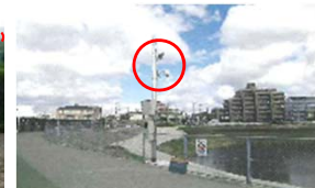
監視カメラの設置
