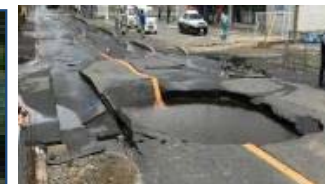
地震による管路の被災状況
