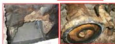
コンクリート腐食状況 ポンプ腐食状況
