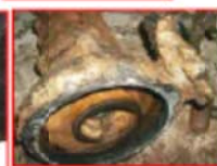
ポンプ腐食状況
