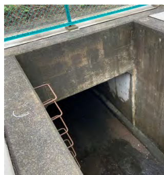
無動力減災ゲート 設置前の開口部
