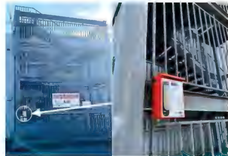
学校施設に設置された様子
