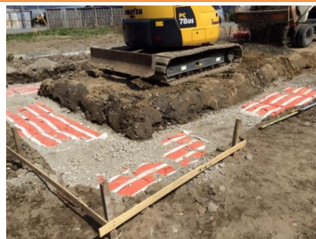
住宅での振動対策での活用
