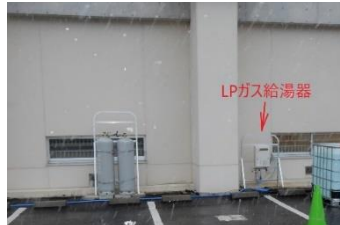
シャワーへの給湯設備
