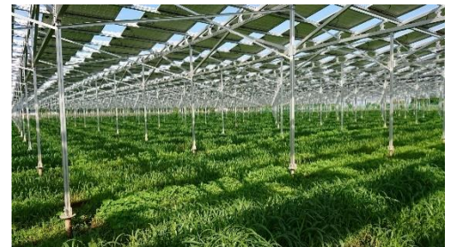
畑の上に太陽光パネルが設置されている 「営農型太陽光発電」
