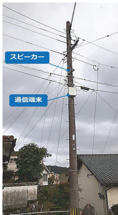
防災電柱の設置状況
