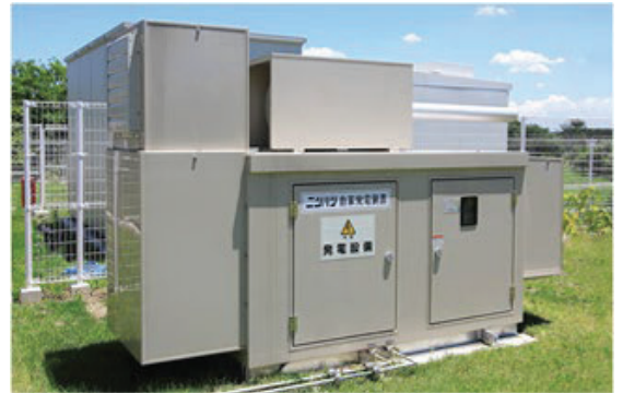
非常用発電設備
