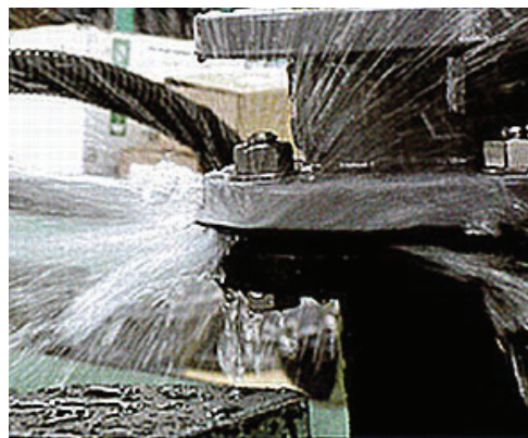
ナットのゆるみによる漏水
