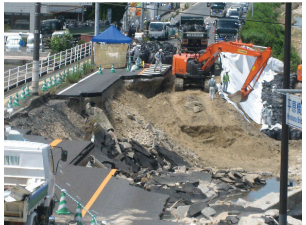
西日本豪雨の被災の様子
