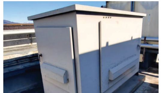
非常用発電設備
