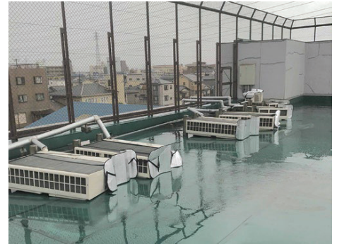
暴風による室外機の転倒
