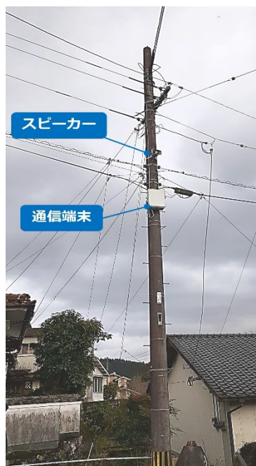
防災電柱の設置状況
