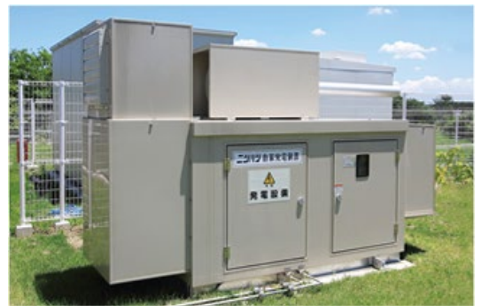
非常用発電設備
