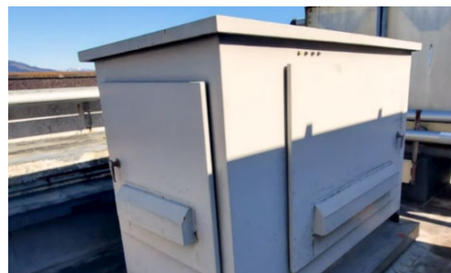
非常用発電設備
