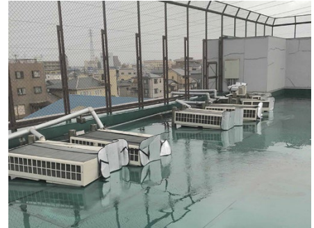
暴風による室外機の転倒
