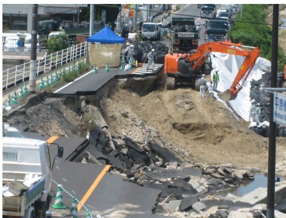
西日本豪雨の被災の様子
