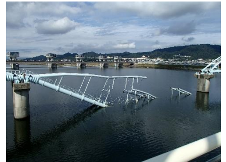
和歌山市で発生した水管橋の崩落
