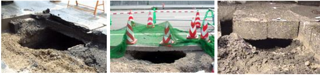
同社の探査により陥没直前で発見された道路の空洞
