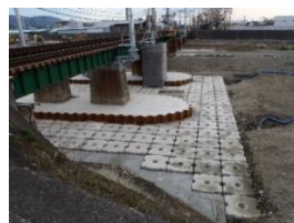
鉄道橋りょうの流失・傾斜対策
