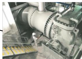
雨水ポンプ場
