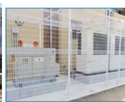
GHP及び非常用発電機
