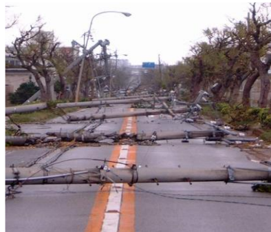
電柱の倒壊による道路閉塞
