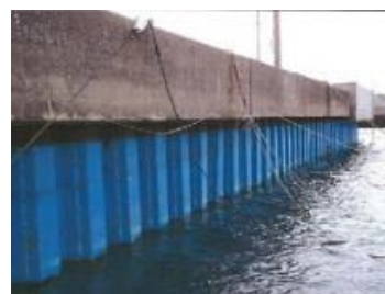
岸壁、鋼製矢板の腐食対策
