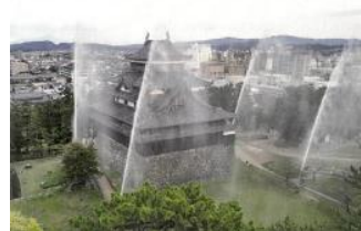
放水銃点検(国宝 松江城天守)
