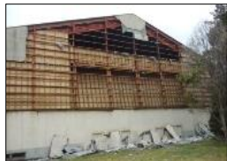
外壁の全面的な脱落事例
