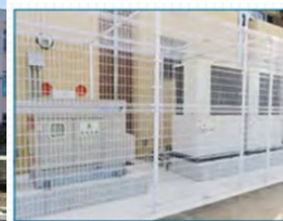
GHP及び非常用発電機
