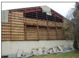
外壁の全面的な脱落事例
