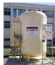
LPガスタンク
