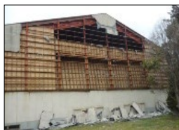
外壁の全面的な脱落事例
