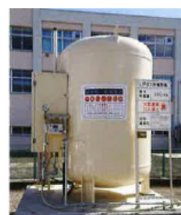
LPガスタンク
