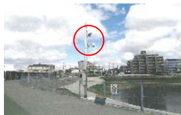
監視カメラの設置
