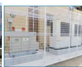
GHP及び非常用発電機
