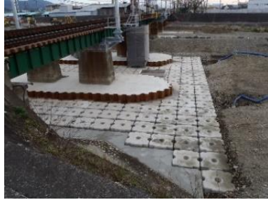
鉄道橋梁の流失・傾斜対策
