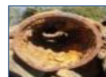
管路の老朽化が進行
