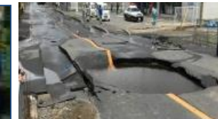
地震による管路の被災状況
