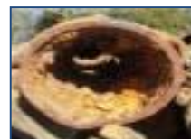
管路の老朽化が進行
