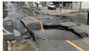
地震による管路の被災状況
