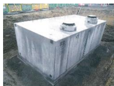
耐震性貯水槽
