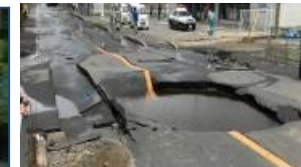
地震による管路の被災状況
