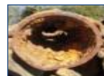
管路の老朽化が進行
