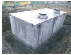
耐震性貯水槽
