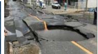
地震による管路の被災状況
