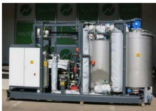
木質バイオマス利用 熱電供給装置
