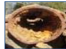
管路の老朽化が進行
