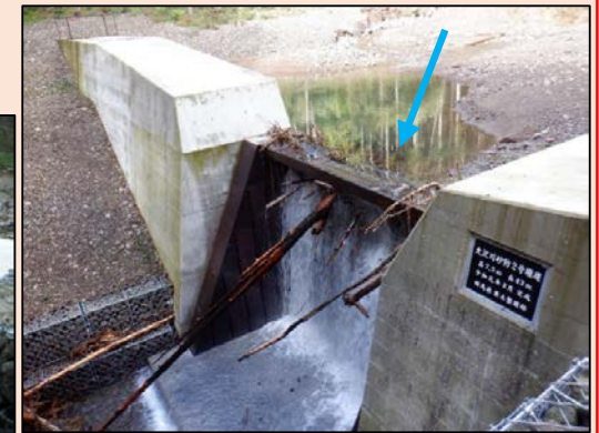
土石流発生後
