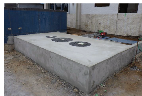
地下燃料タンク
