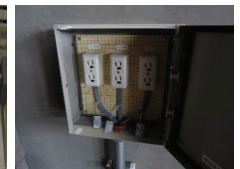
非常用コンセント
